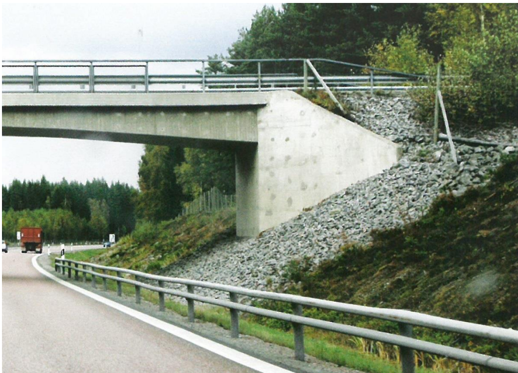
Figur 3-11 Slänter med öppna krossytor ger ett slarvigt och ofärdigt uttryck. (Foto från Vägen, B. Birgersson)
