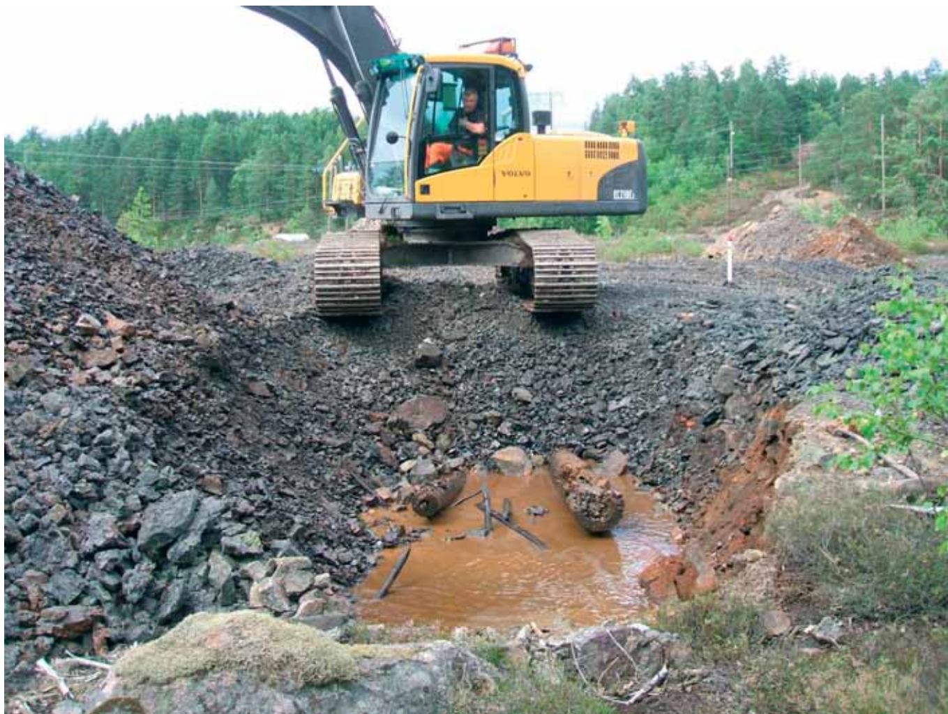
Schakt 17. Inge Bäck, Västerviks grävmaskiner, schaktar fram två pipstockar i norra delen av schaktet. Foto: E Carlsson.
