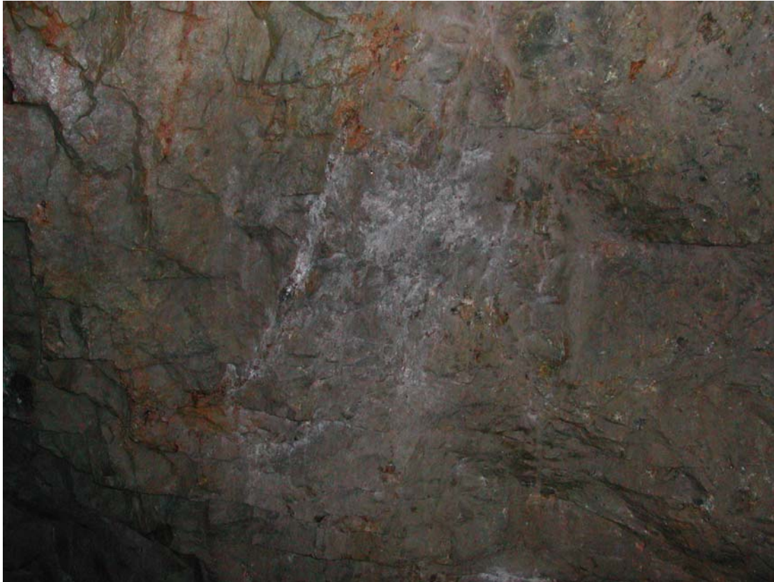
Bild 4. Vita gipsutfällningar på schaktväggen i Bondegruvan.
