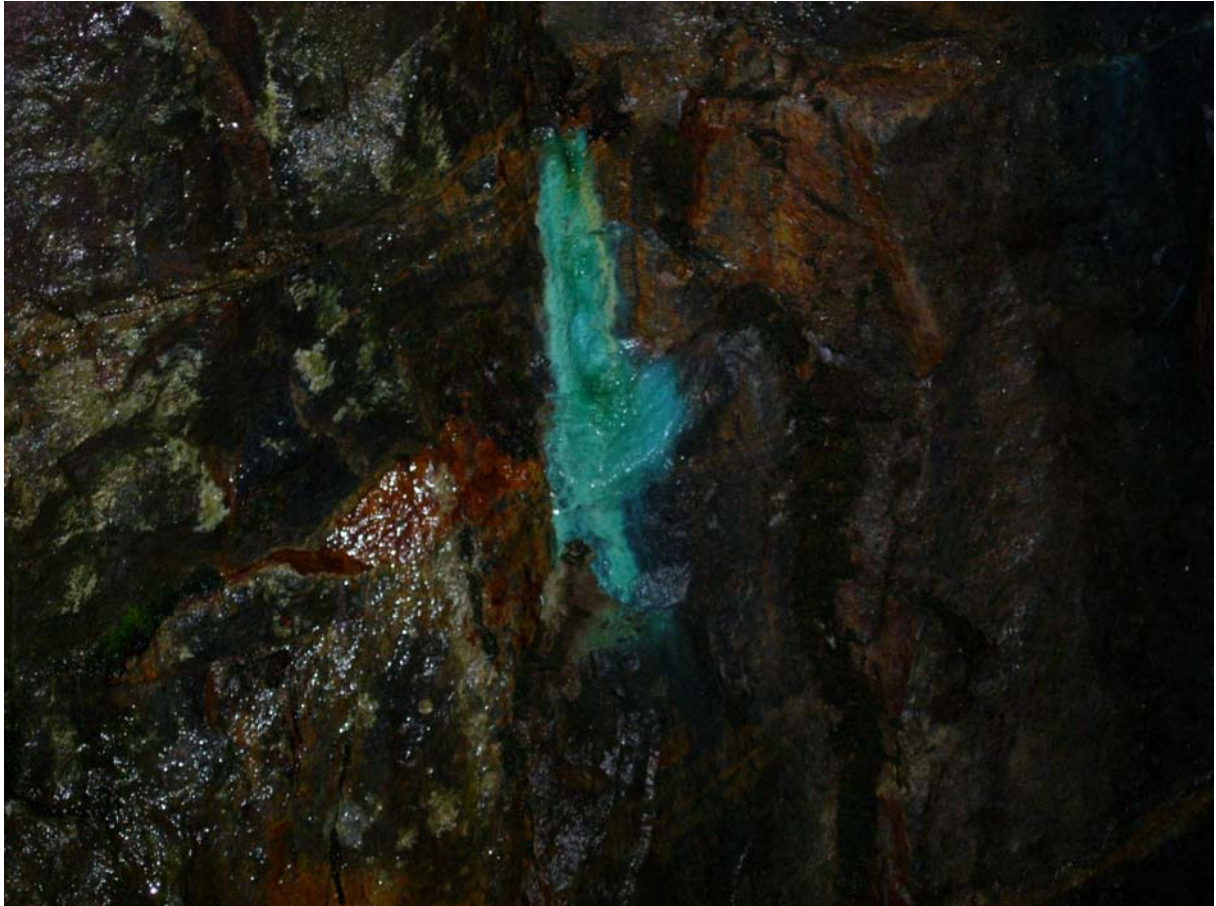
Bild 7. Utfällningar på schaktvägg, Knuts schakt.
