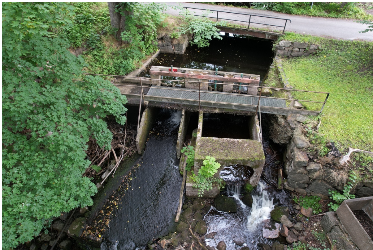
Figur 4. Övre Bruksdammen som är i mycket dålig kondition.
