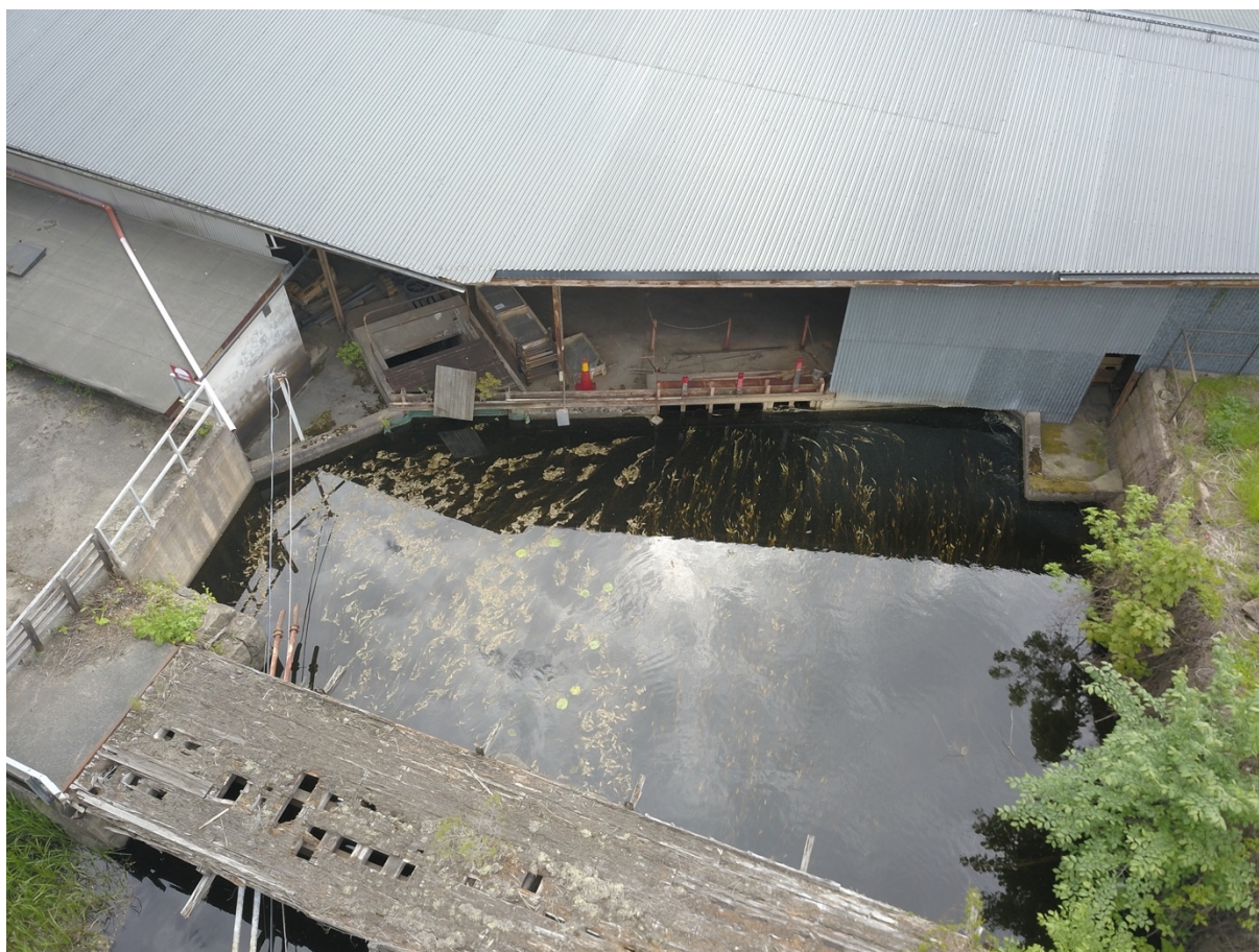
Figur 5. Övre Kvarndammen är trång belägen. Dammen bedöms hålla bättre kondition än övriga, även om läckage mm förekommer.
