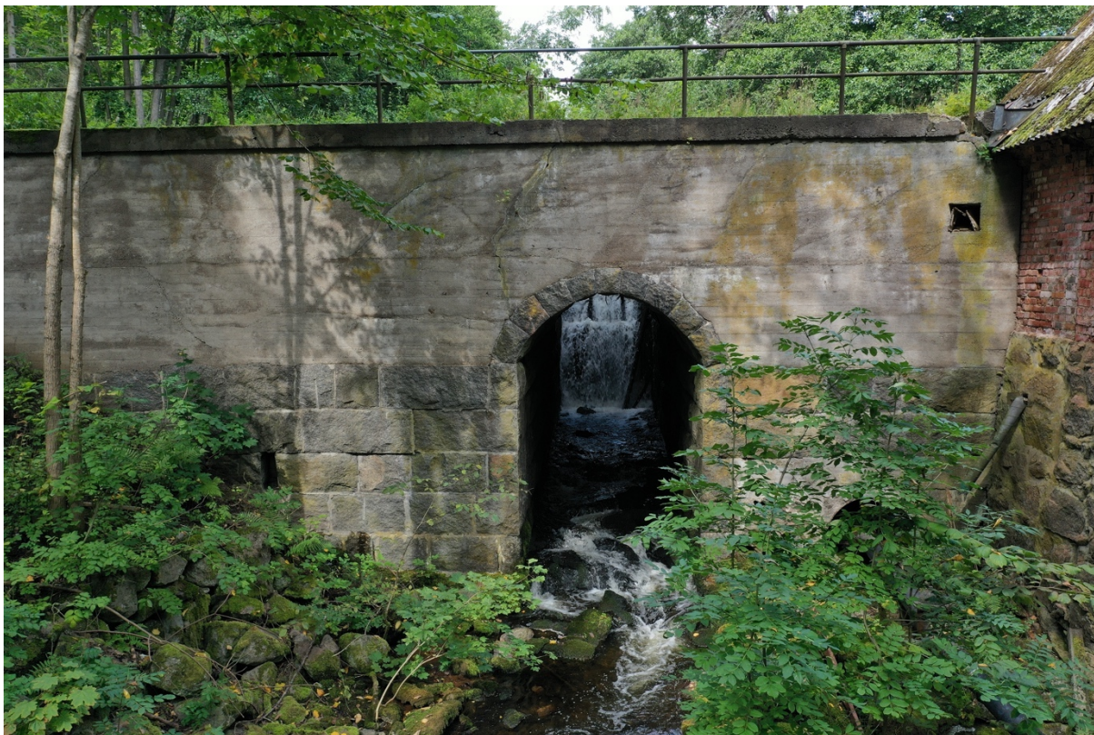
Figur 6. Kvarndammen och kvarnbyggnaden till höger i bild. Den omfattande tröskelupbyggnaden under lucktskovet syns i bild. Läckage är omfattande och dammbrott skulle resultera i ekonomiska skador. Föreslagen avsänkning skulle begränsa vattentrycket och leda till eliminerad risk för dammbrottsflöden.
