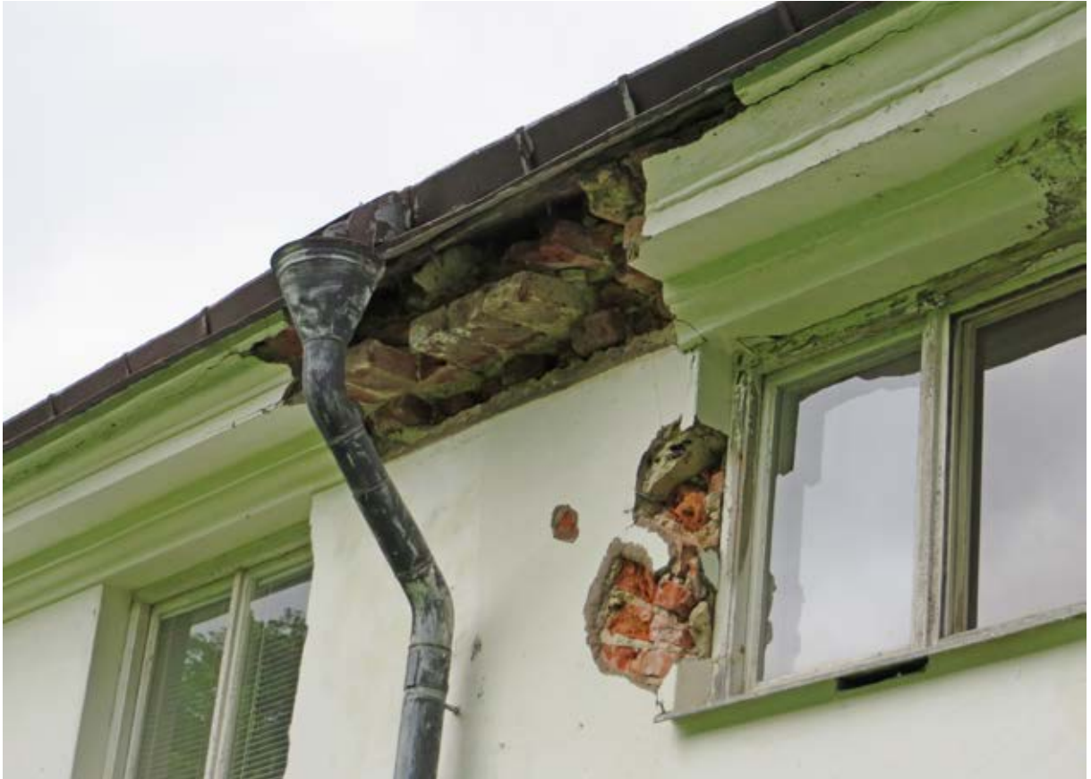
Den bristfälliga vattenavrinningen från taket har lett till skador på takfoten där delar av putsen och tegelstommen fallit bort.
