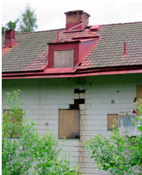
"Övre Knäppet". Ett långvarigt takläckage intill en av de två takkuporna har gett omfattande rötskador på husets stomme och bjälklag.
