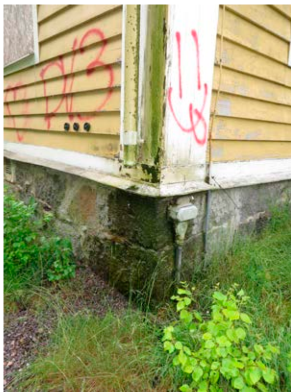
Några av stuprören saknar utkastare vilket i förlängningen kan ge skador på sockeln.
