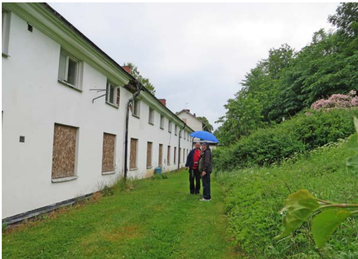
Marken bakom "Övre stenhuset" sluttar ned mot byggnaden, vilket medför en stor fuktbelastning på huset.
