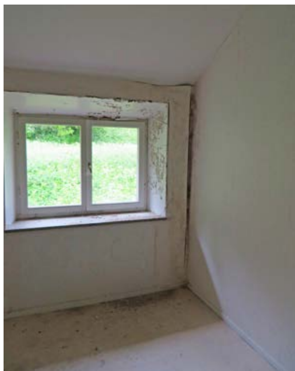
Tydliga fuktgenomslag i ett av rummen innanför där skadan finns.
