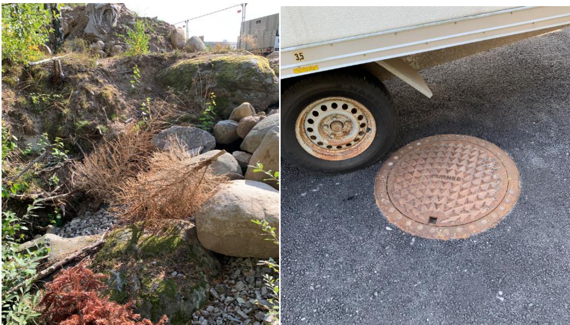
Figur 9 . Vid dikets inlopp strax utanför fastighetens norra gräns. Figur 10 Oljeavskiljare innanför fastigheten
