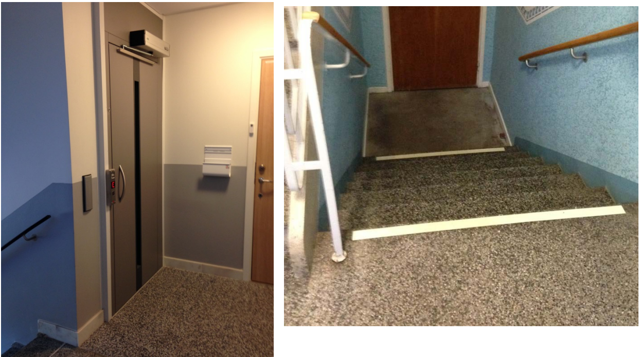
Exempel på bra tillgänglighet; dörröppnare i entrén, hiss med dörröppnare samt kontrastmarkerade trappor.
