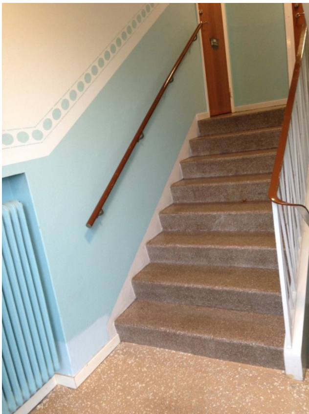
En vanlig syn i trapphusen, ingen kontrastmarkering.
